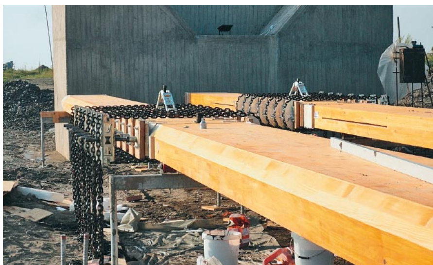
Die Brückenträger wurden in LKW-tauglichen Längen von 13,5 Metern nach Georgien transportiert und dort bauseits zu den fast 50 Meter langen Gurten der Regelbauteile zusammengeleimt.
