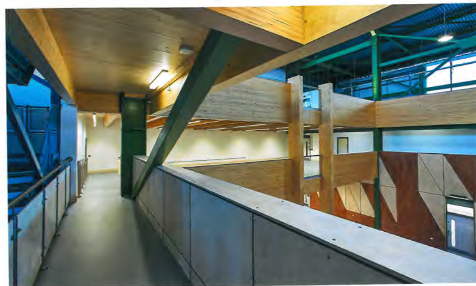
Aufgrund der niedrigen Raumhöhe kam Bau-Buche von Pollmeier zum Einsatz. Die hohe Festigkeit der Träger ermöglichte schlanke Konstruktionen für die erforderlichen Spannweiten.
