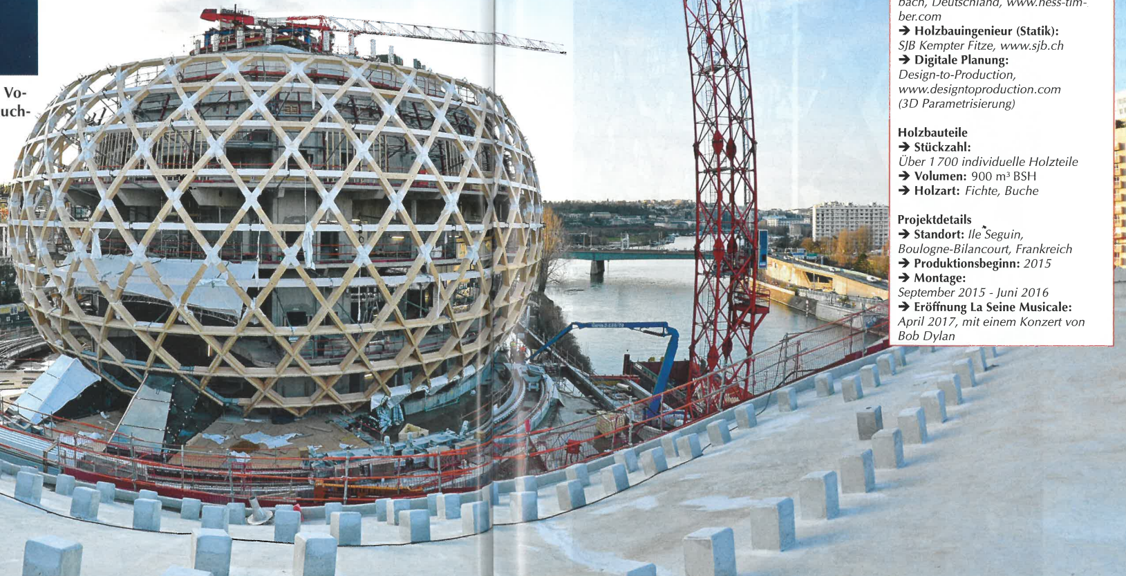
Fisheye-Ansicht der Baustelle „La Seine Musicale“ mit fertigem Auditoriums-Tragwerk. Gut sichtbar sind auch die Schienen für das umlaufende Solarpanel (Foto: JF Wegerich)
