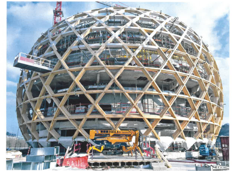
Außenansicht des „La Seine Musicale“-Tragwerks vor Abschluss der Montagephase (Foto: Mathias Hofmann)
